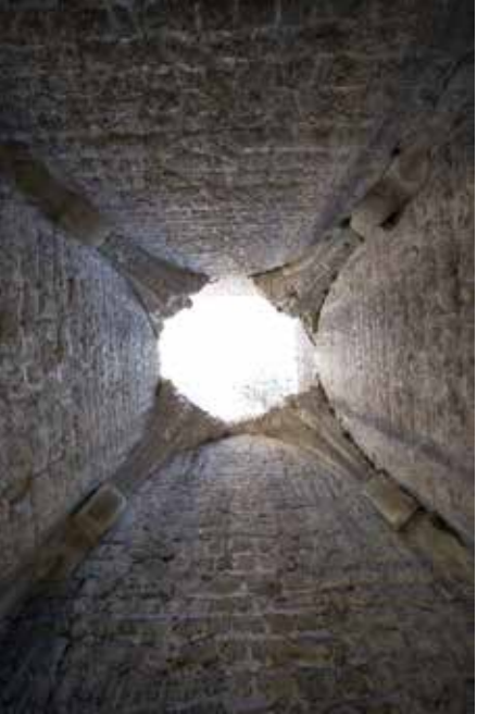
le reste de voûte
