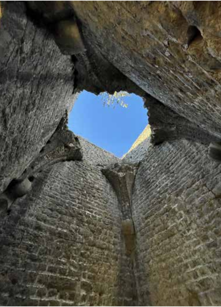
le reste de voûte
