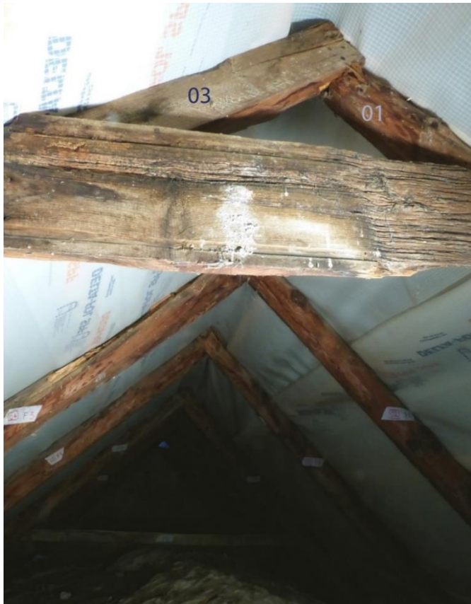
Charpente des combles vue depuis le nord. Un bardeau remployé fait office d'entrait retroussé sur la ferme au premier plan (Photographie L. Shindo, ROOTS, CAU, Kiel).
