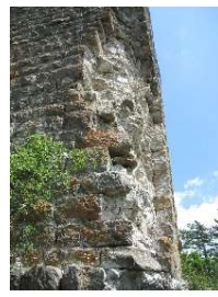
Arrachement de pierres aux angles
